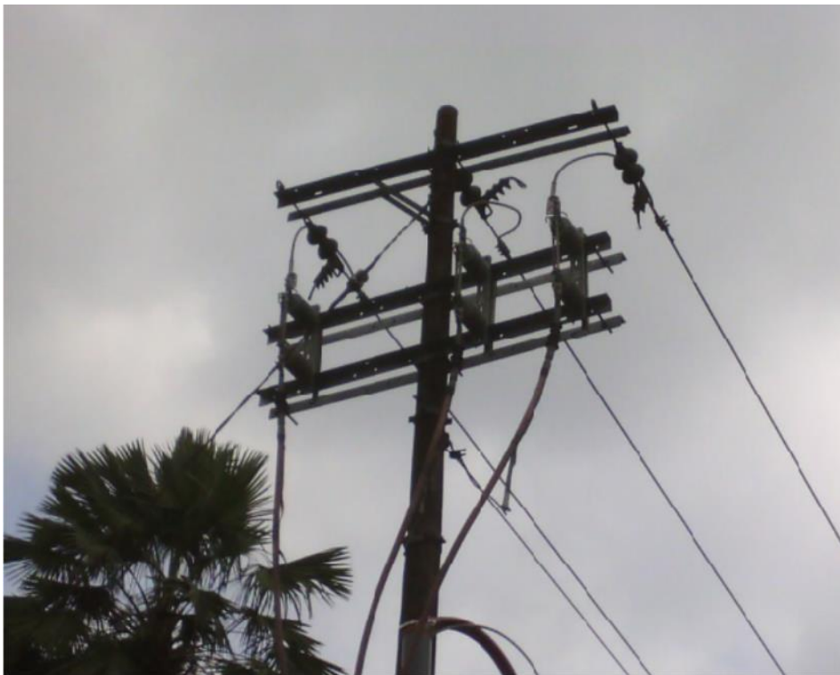
Figura 7: Poste de luz CNEL EP Santo Domingo Av. Quito
