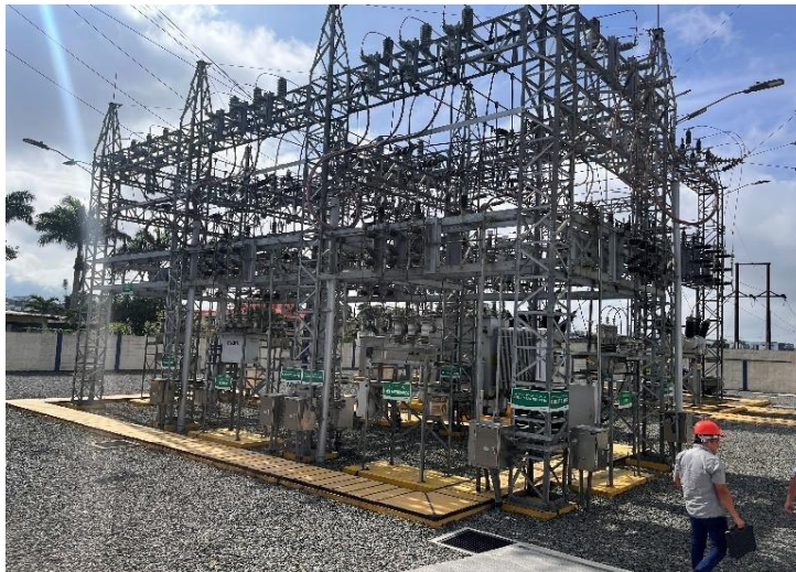
Figura 1: Subestación CNEL EP Santo Domingo - Av. Quito
