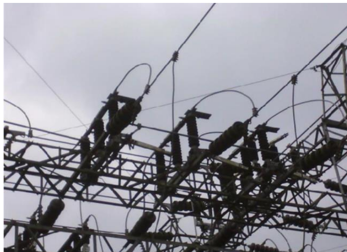
Figura 6: Análisis termográfico de Tripolar de salida Posición 1 CNEL EP
