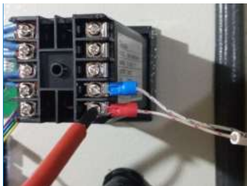
Figura N° 10. Instalación de una termocupla tipo k.
